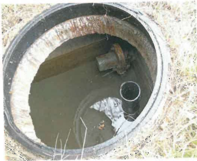
Chambre annexe de décantation
